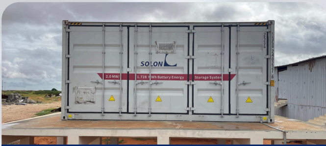
IPP, East Africa, 31.14 MWh BESS
